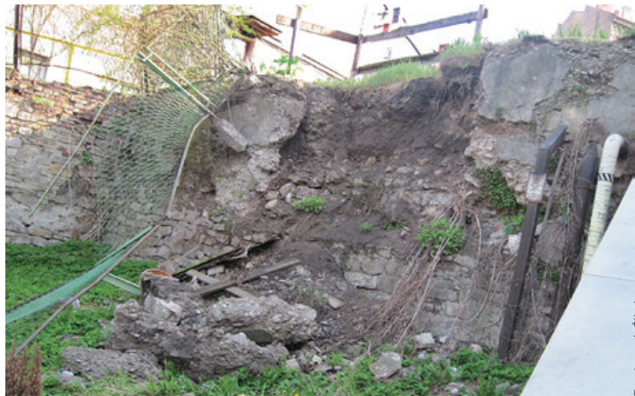
Zawalony mur oporowy – 13 kwietnia 2016 r.
